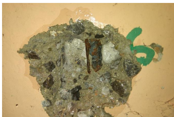
Prut ØV12 napadený korozí.
