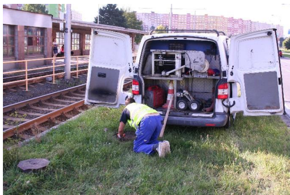
Kamerová prohlídka kanalizace v pásu zeleně v linii výstupu č. 3. Vlevo v popředí průzkumný vrt (?).
