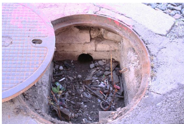
Šachtice odvodnění nástupiště zastávky u výstupu č. 4 (směr Poruba). Odpadní potrubí je vyústěno do šachtice, která je situována v kolejišti tramvaje.
