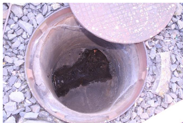
Šachta traťové kanalizace, která je samostatnou větví – v prostoru zastávky MHD není napojena na kanalizační řad.
