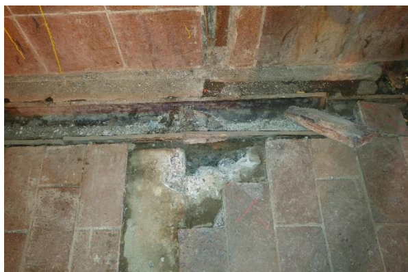
Sonda č. 3 – Průsaky vlhkosti ve stěnové dilataci a pod odstraněnou dlažbou. V horní části dodatečně instalovaný kameninový žlábek, který není dobře uložen v maltovém loži.
