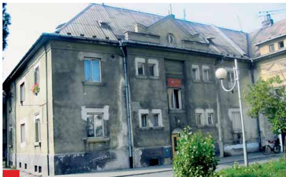
V plánu pro letošní rok nechybí pokračující rekonstrukce domů v oblasti Jubilejní kolonie.
