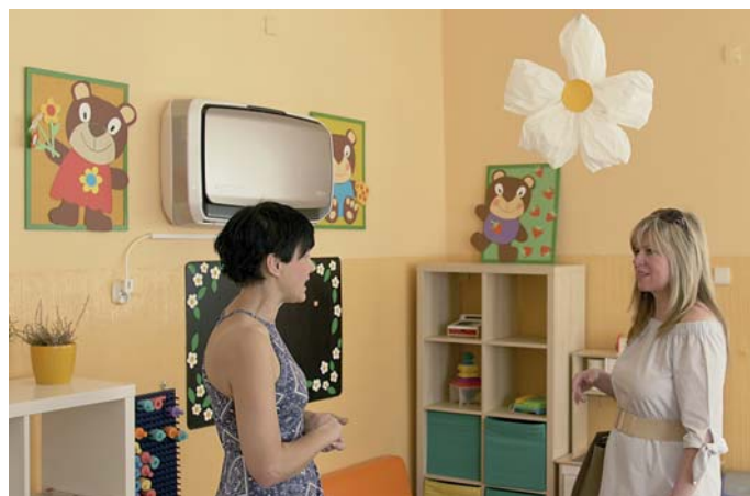
Takto je jedna z čističek vzduchu nainstalována v MŠ Patricie Lumby 25.
